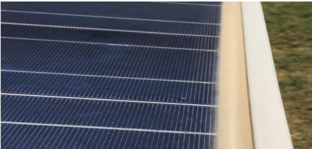
Hình 6. Bụi bẩn tích tụ cuối tấm pin do vệ sinh sai cách
